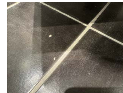
Sår i gulvfliser.
