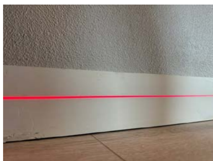
Bilder viser skjevheter i gulv i stue/kjøkken.
