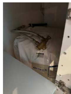
Varmtvannstank i kjøkkenskap.
