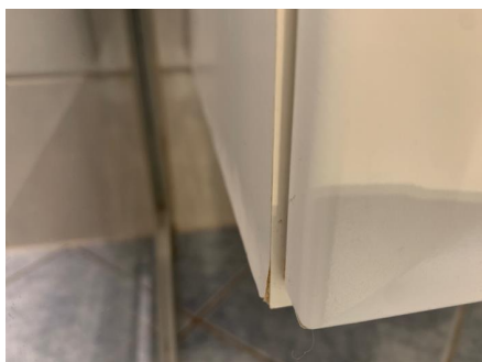
Antydning til svelling. Bør utføres lokal utbedring
