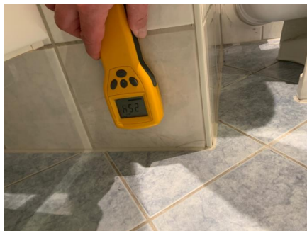
Indikerer fukt på disse flisene.
