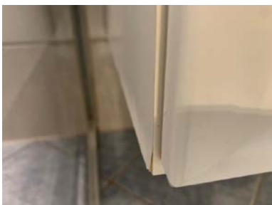
Antydning til svelling. Bør utføres lokal utbedring
