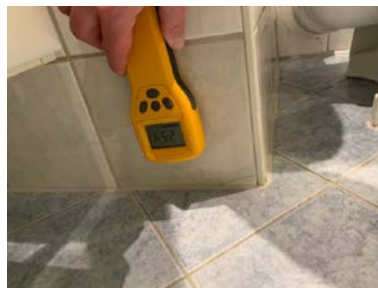
Indikerer fukt på disse flisene.
