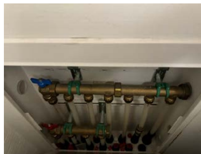
Fordelerskap for rør i rør
