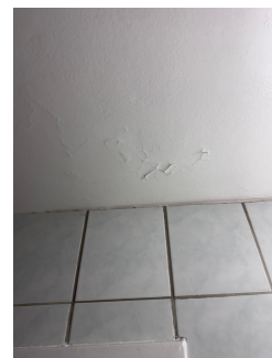
Krakkelering av maling i innvendig tak.
