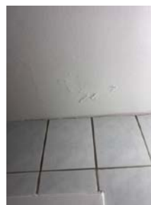
Krakkelering av maling i innvendig tak.
