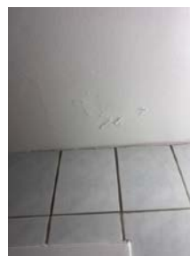
Krakkelering av maling i innvendig tak.
