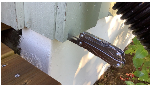
Eksempel på råteskadet kledning.
