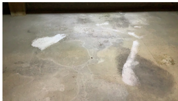
Eksempel på saltutslag på betonggulv.
