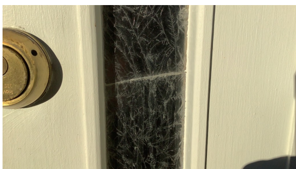
Sprukket glass i ytterdør.
