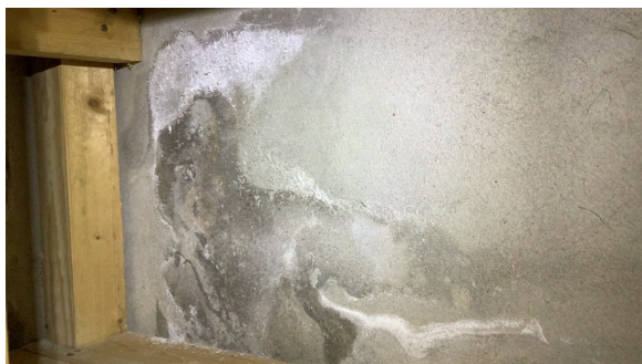
Eksempel på saltutslag på grunnmur.
