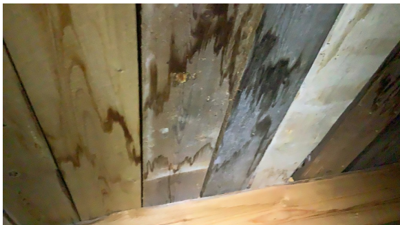
Fuktskjolder i taktro inntil pipe.
