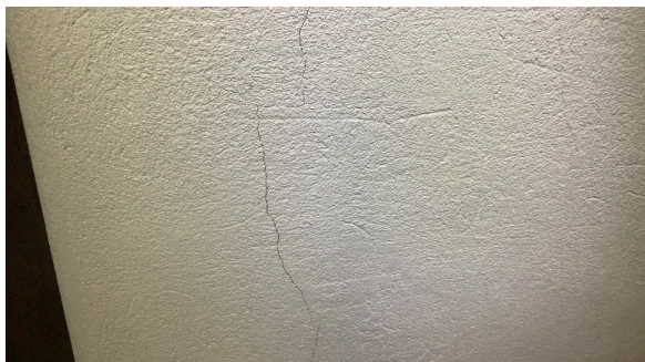
Riss i puss på pipe.
