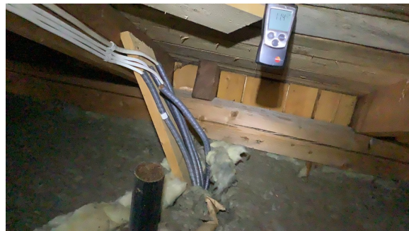
Det er ikke montert lufteventil på avløpslufting på loft.
