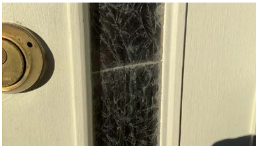
Sprukket glass i ytterdør.
