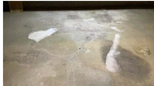
Eksempel på saltutslag på betonggulv.
