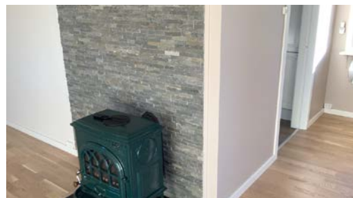
En pipevange er innkledd bak delevegg.
