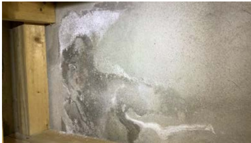
Eksempel på saltutslag på grunnmur.
