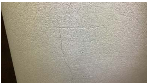
Riss i puss på pipe.
