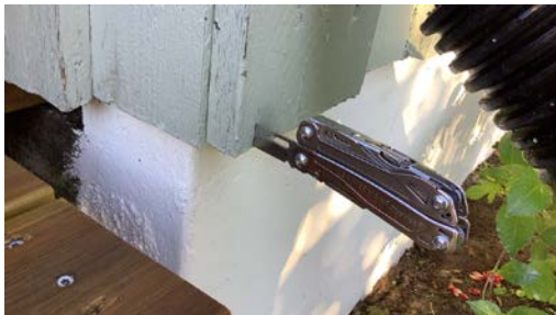
Eksempel på råteskadet kledning.
