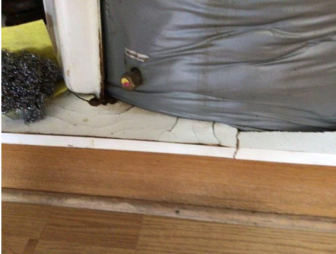
Skader i bunnen av kjøkkenskap under varmtvannsberederen
