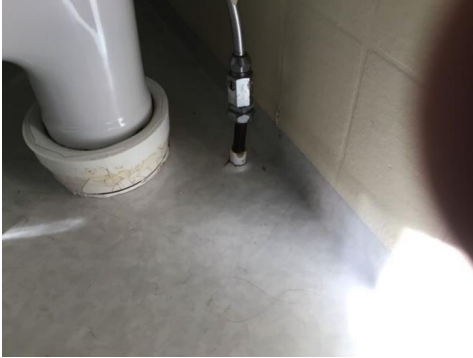
Utett rund vannrør bak toalett
