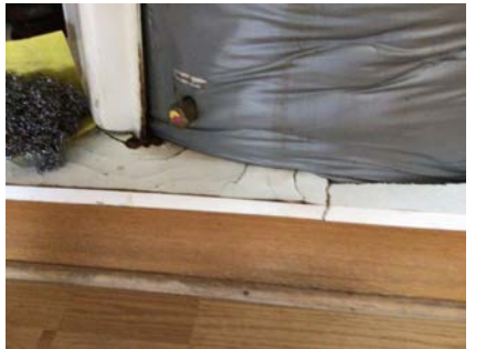
Skader i bunnen av kjøkkenskap under varmtvannsberederen
