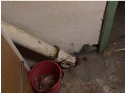
soil rør i kjelleren
