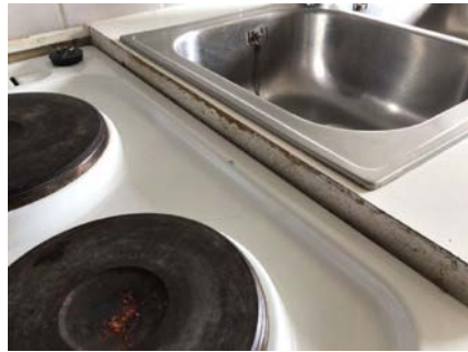
Skader på benkeplate
