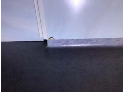
Skader i bunn av våtromsplate
