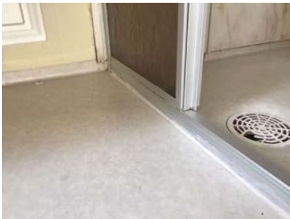
Ikke tilgang til sluk fra hele gulvet.
