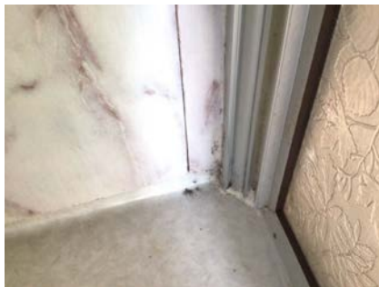
Utettheter i plateskjøt i dusj
