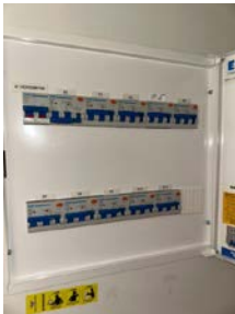
Sikringsskap med automatsikringer.
