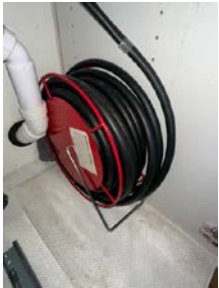
Brannslange montert på kjøkken
