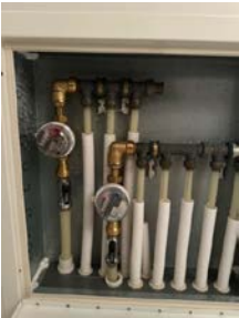
Samleskap med rørkurser og stoppekraner
