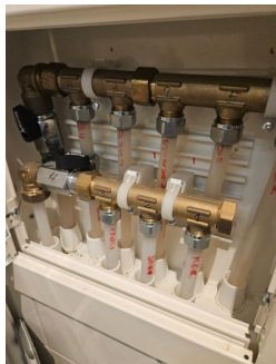
Fordelerskap for rør i rør system.
