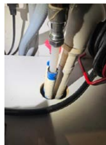
Vannrør mangler plugging i benkeskap på kjøkken.
