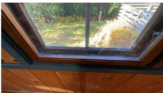
Synlige skader generelt.
