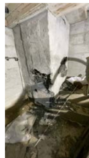
Nedre del av pipeløp må utbedres før videre bruk.
