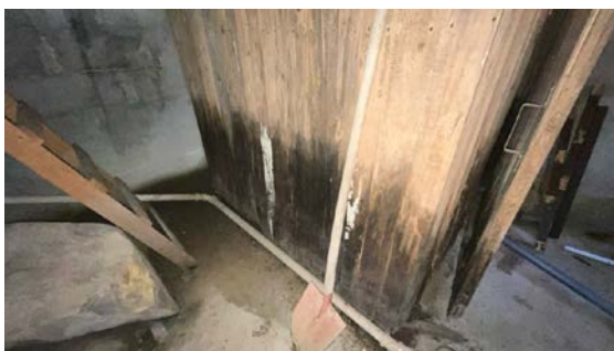
Det er påvist synlige fukt/råteskader i treverk i underetg./kjeller, hulltaking er derfor ikke nødvendig
