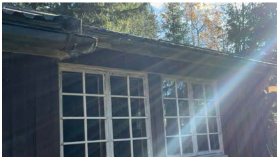
Det er påvist avvik i beslagløsninger.
