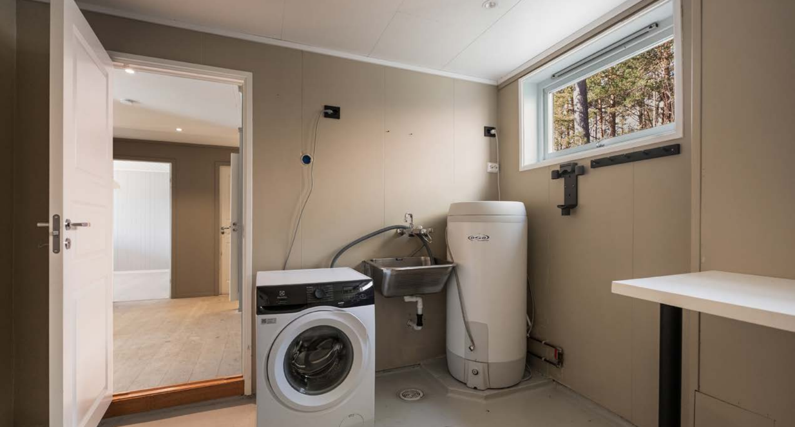
Vaskerommet er utstyrt med vaskemaskin, skyllekum og varmtvannsbereder.
