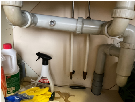
Vannledninger og avløpsrør i kjøkkenskapet
