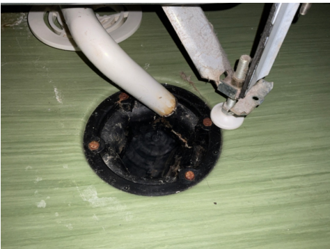
Sluk under dusjkabinett
