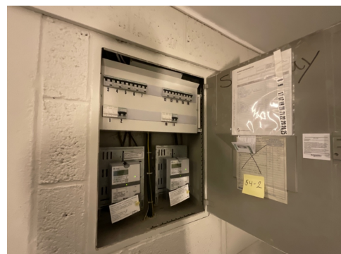
Sikringskap i felles trappegang
