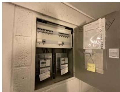
Sikringsskap i felles trappegang
