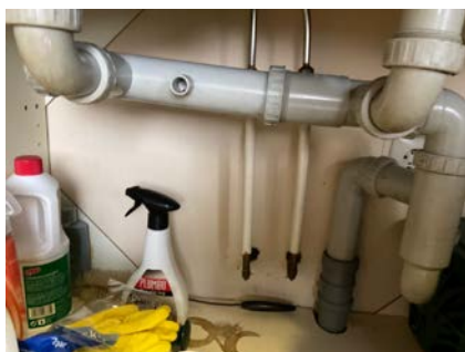
Vannledninger og avløpsrør i kjøkkenskapet
