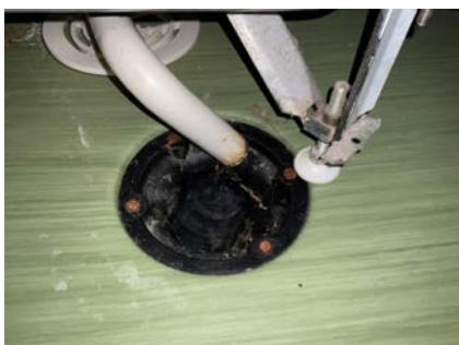
Sluk under dusjkabinett
