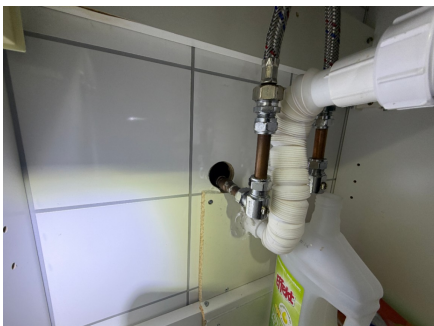
Ikke tettet rundt rørgjennomføringer i vegg
