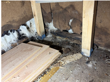
Fukt gjennom grunnmur
