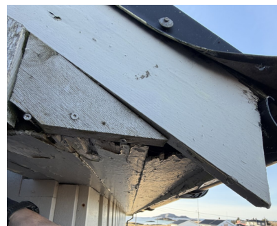
Råte i gesimskasse/vindskier
