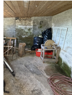
Fuktopptrekk i gulv langs innvendig bærevegg
