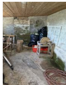
Fuktopptrekk i gulv langs innvendig bærevegg
