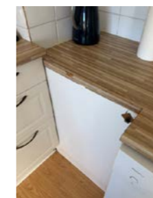
Laminat har løsnet på benkeplate
