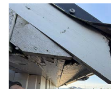
Råte i gesimskasse/vindskier
