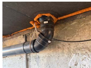
Kondensfukt fra rør synlig på asfaltplaten.
