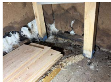
Fukt gjennom grunnmur
