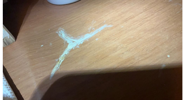
Brudd i gulvbelegg, med provisorisk tetting.
