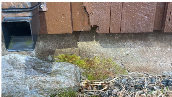
Sprekk i grunnmur.
