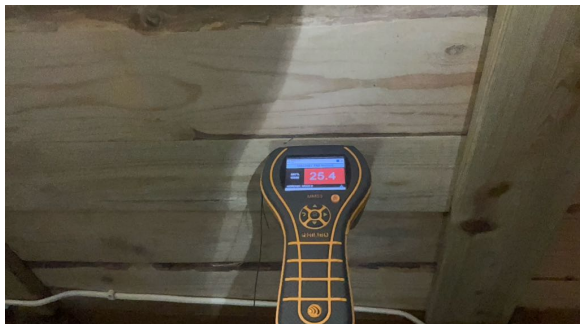
Fuktmåling i etasjeskiller viste skadelige verdier.
