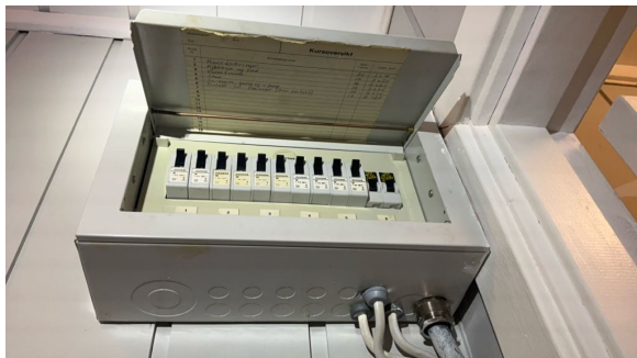
Sikringsskap er plassert ved entré.
