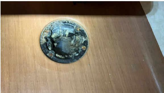
Kontroll av sluk. Rust på skruer.
