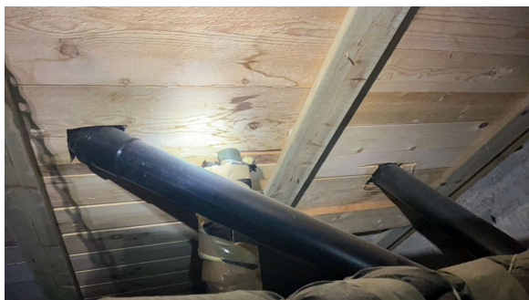
Fuktmerker rundt rørgjennomføringer i krypkjeller.
