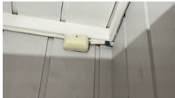
Uisolert kabel utenfor koblingsboks. Forholdet gis tilstandsgrad 3.
