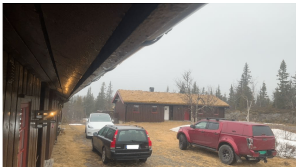
Skjevheter/ujevnheter i takkonstruksjonen.
