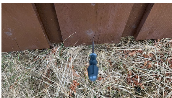
Råteskadet kledning registrert.
