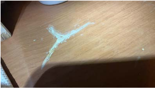
Brudd i gulvbelegg, med provisorisk tetting.
