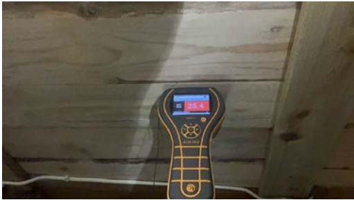
Fuktmåling i etasjeskiller viste skadelige verdier.
