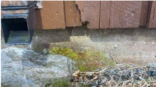
Sprekk i grunnmur.
