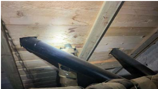
Fuktmerker rundt rørgjennomføringer i krypkjeller.
