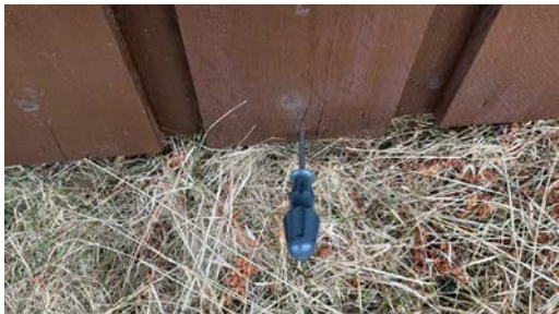
Råteskadet kledning registrert.
