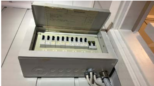
Sikringsskap er plassert ved entré.
