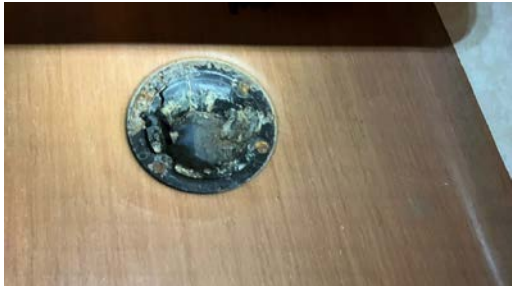
Kontroll av sluk. Rust på skruer.
