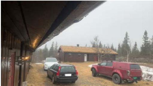
Skjevheter/ujevnheter i takkonstruksjonen.
