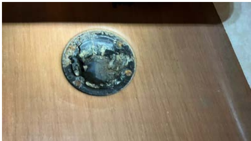
Kontroll av sluk. Rust på skruer.
