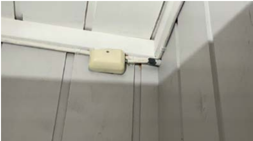
Uisolert kabel utenfor koblingsboks. Forholdet gis tilstandsgrad 3.
