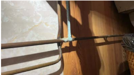
Tegn på tidligere lekkasjer, irr på rør.
