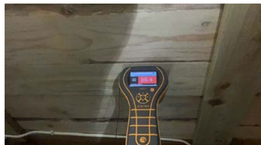
Fuktmåling i etasjeskiller viste skadelige verdier.
