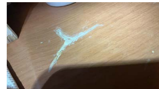
Brudd i gulvbelegg, med provisorisk tetting.
