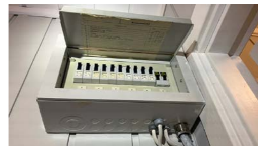
Sikringskap er plassert ved entré.
