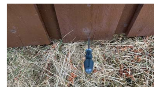
Råteskadet kledning registrert.
