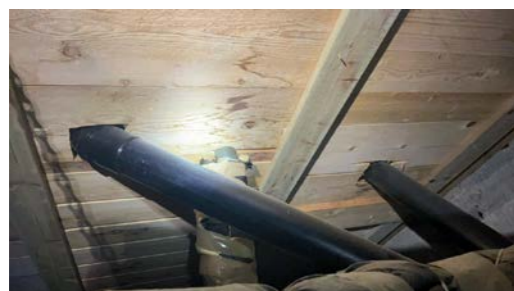
Fuktmerker rundt rørgjennomføringer i krypkjeller.
