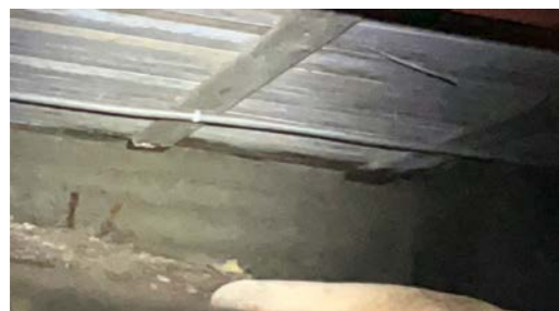
Synlig fukt i etasjeskiller på nordsiden i krypkjeller.
