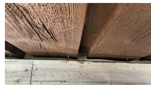
Glippe mellom veranda og yttervegg. Sannsynligvis grunnet bevegelser i konstruksjonene.
