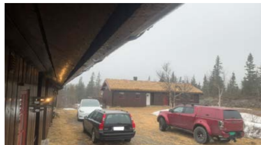
Skjevheter/ujevnheter i takkonstruksjonen.
