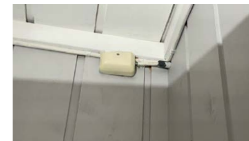
Uisolert kabel utenfor koblingsboks. Forholdet gis tilstandsgrad 3.
