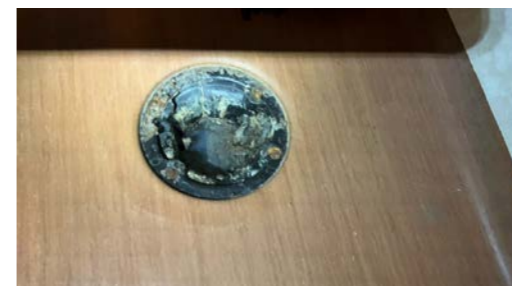
Kontroll av sluk. Rust på skruer.
