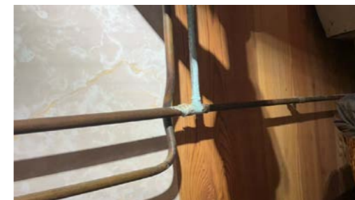
Tegn på tidligere lekkasjer, irr på rør.
