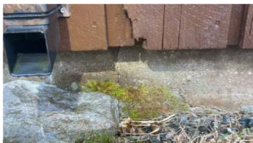
Sprekk i grunnmur.
