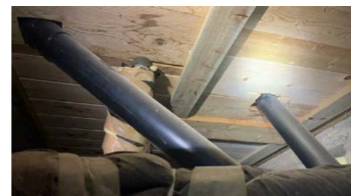
Fuktmåling viste skadelige verdier. Dette må sannsynligvis også sees i sammenheng med krypkjeller i rapporten.
