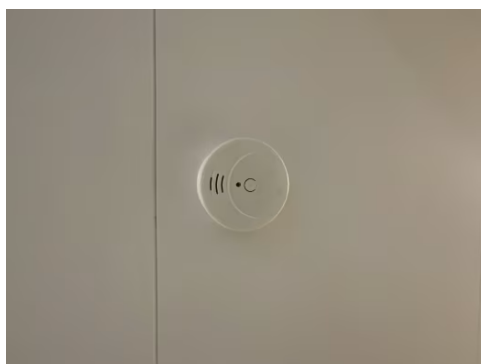
Viser brannvarsling i himling.
