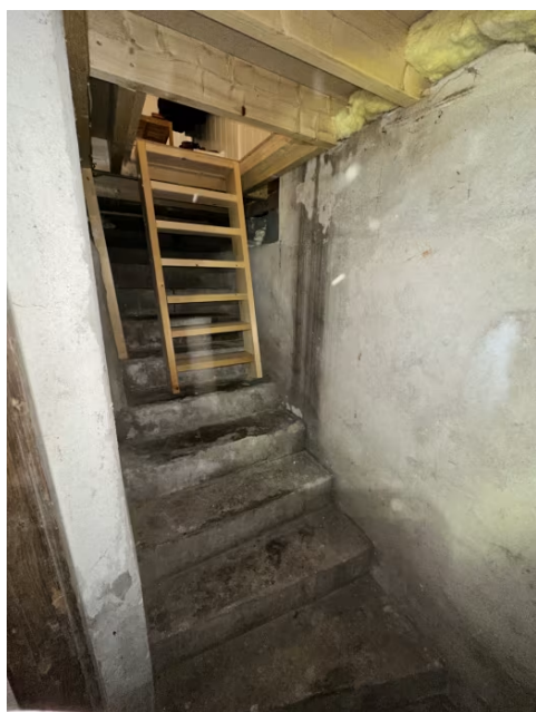
Viser trapp med adkomst til kjeller. Trappen tilfredsstillende ikke dagens krav til sikkerhet.
