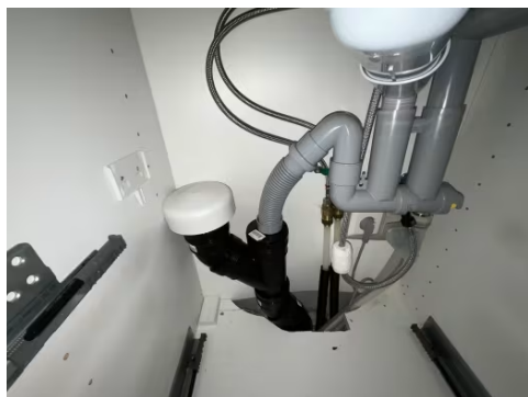
Viser vann og avløpsinnstallasjoner under kum.
