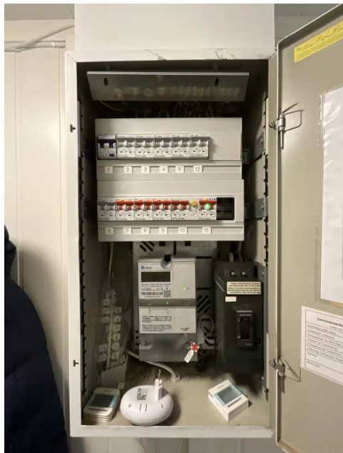
Viser sikringsskap plassert i gang.
