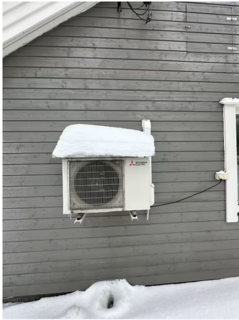
Viser utedel luft til luft varmepumpe.
