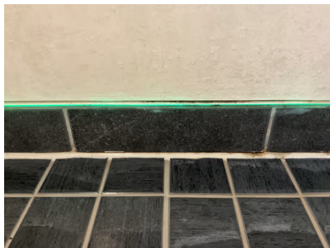
Silikonfuger med behov for lokale utbedringer.
