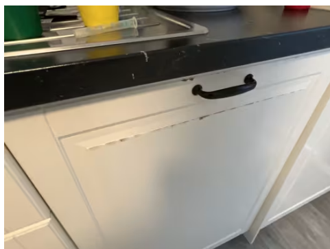
Det registreres svelleskade på front til oppvaskmaskin og front under vask trolig pga vannsøl.
