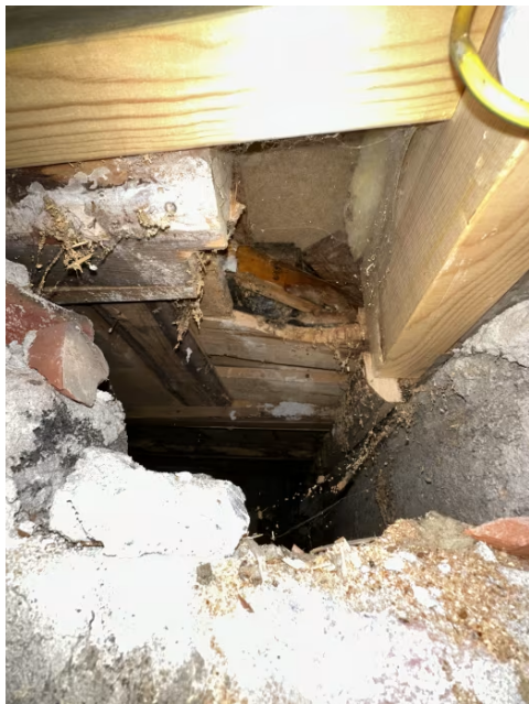
Følgeskader i takkonstruksjonen grunnet tidligere utett våtrom.
