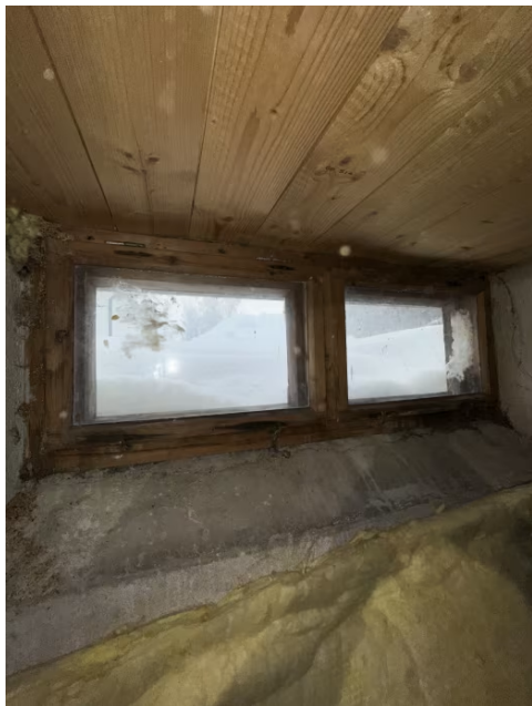
Viser kjellervindu med vareindu fra byggeåret. Det registreres fuktskjolder i ramtre.
