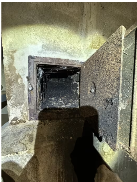
Viser sotluke plassert i kjeller.
