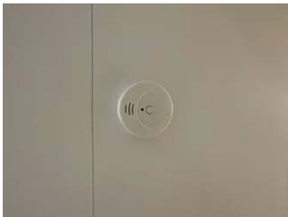
Viser brannvarsling i himling.
