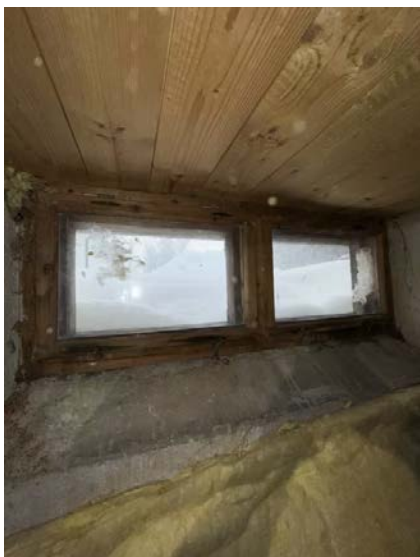
Viser kjellervindu med varevindu fra byggeåret. Det registreres fuktskjolder i ramtre.
