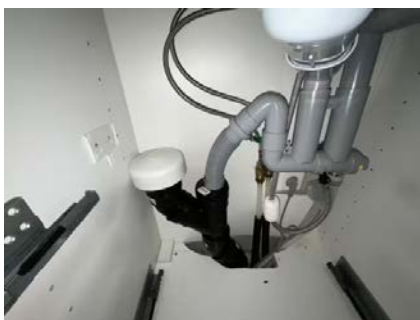
Viser vann og avløpsinnstallasjoner under kum.
