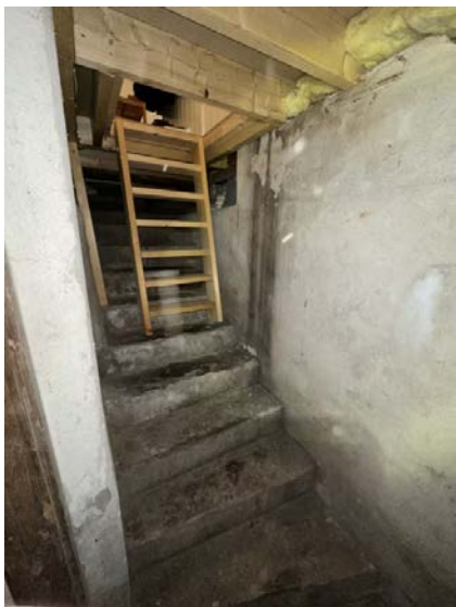
Viser trapp med adkomst til kjeller. Trappen tilfredsstillende ikke dagens krav til sikkerhet.
