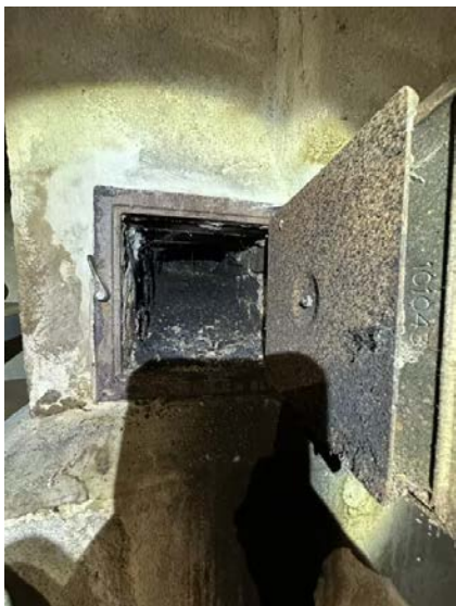
Viser sotluke plassert i kjeller.
