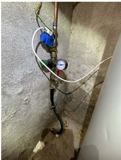
Viser vanninntak, magnetventil og hovedstoppekran plassert i kjeller.
