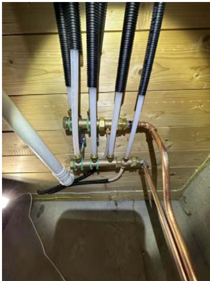
Viser fordeler for rør i rør montert i himling i kjeller.
