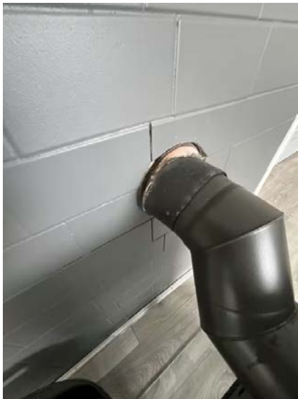
Fliser på brannmur og pipevanger med sprekker og boom under flis.
