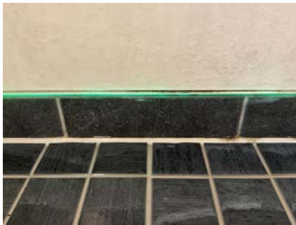
Silikonfuger med behov for lokale utbedringer.
