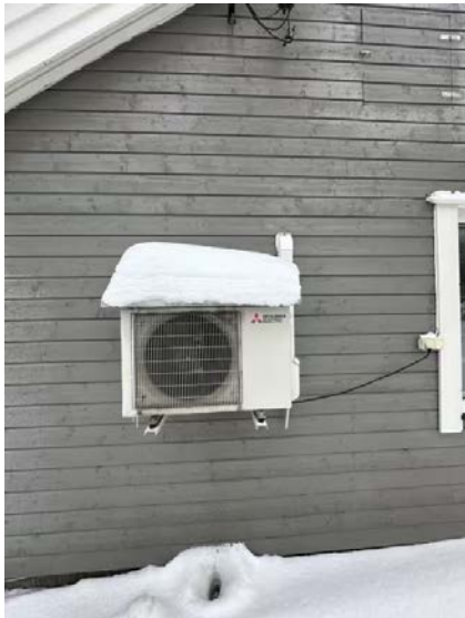
Viser utedel luft til luft varmepumpe.
