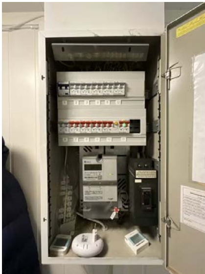
Viser sikringsskap plassert i gang.
