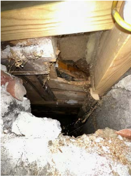
Følgeskader i takkonstruksjonen grunnet tidligere utett våtrom.
