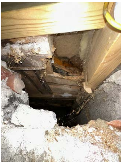
Følgeskader i takkonstruksjonen grunnet tidligere utett våtrom.
