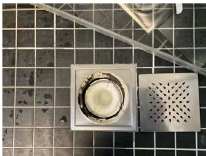
Viser sluk i dusjsonen.
