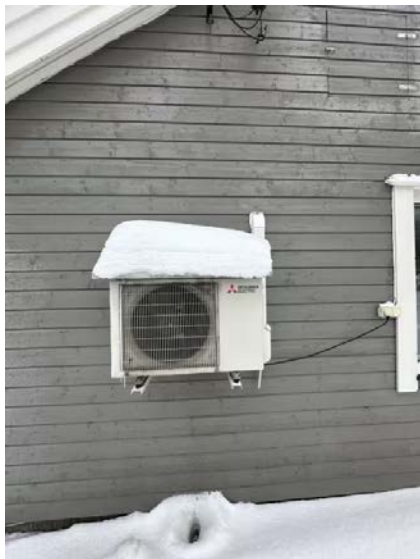
Viser utedel luft til luft varmepumpe.
