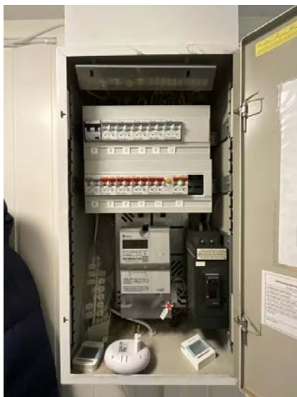
Viser sikringsskap plassert i gang.
