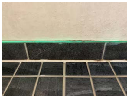
Silikonfuger med behov for lokale utbedringer.
