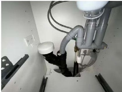
Viser vann og avløpsinnstallasjoner under kum.
