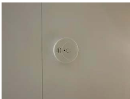
Viser brannvarsling i himling.
