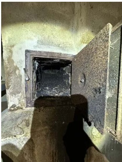
Viser sotluke plassert i kjeller.
