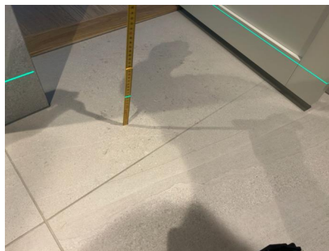
Slukrenne langs vegg.
