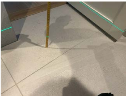
Slukrenne langs vegg.
