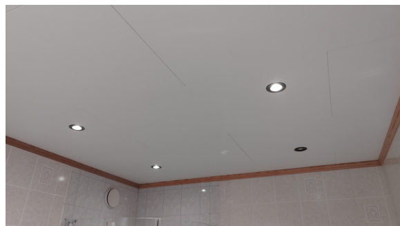
Noen av spottene i himlingen fungerte ikke ved befaring.
