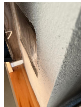
Manglende plate på gulv under sotluke
