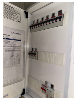
Sikringskap med automatsikringer.
