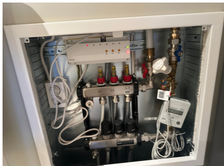
Samleskap for gulvvarme
