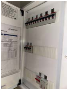
Sikringsskap med automatsikringer.
