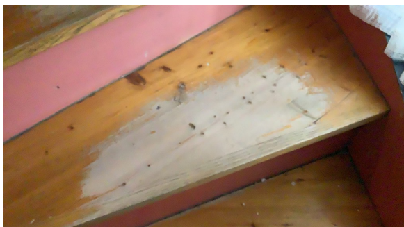
Slitasje i trapp.
