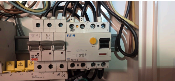
Bilde 1 Testknapp virket ikke. Det er nok feilkobling. Testknapp er nok koblet mellom N og L3. Lask eller flytte leder.
