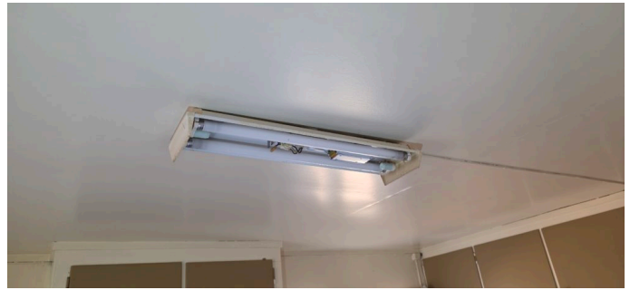
Bilde 2 Lampe tak mangler skjerm og er løs i enden
