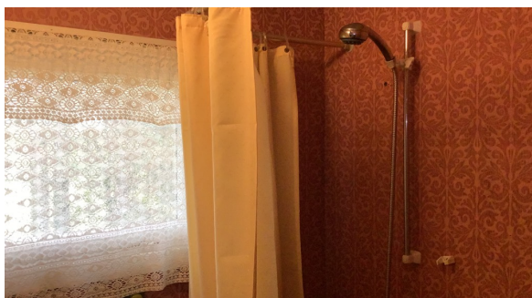
Vindu er plassert i den definerte våtsonen.
