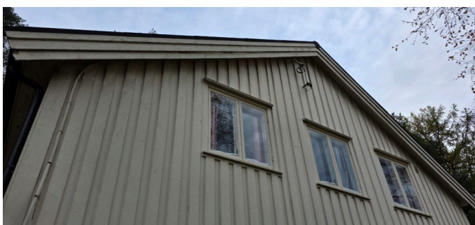
Bilde 5 Gamle inntakskabel bør fjernes.
