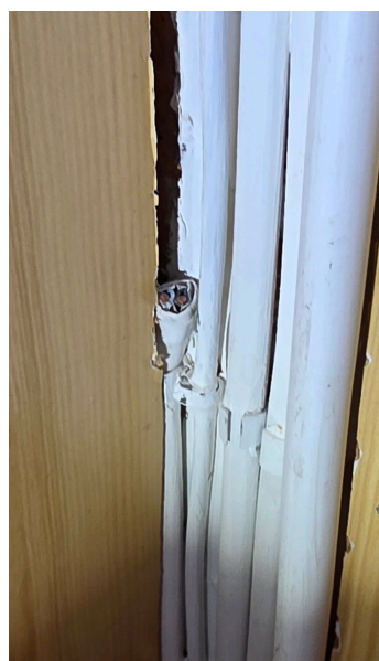
Bilde 6 Kabel ikke korrekt avsluttet. Under sikringskap i 2 etasje
