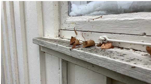
Vannbrett har ikke tilfredsstillende fall fra vindu.
