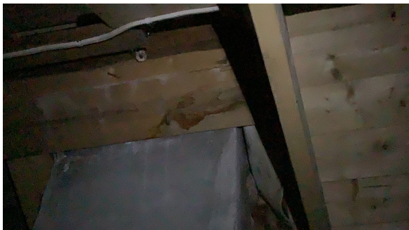
Fuktskjolder i taktro inntil pipe.
