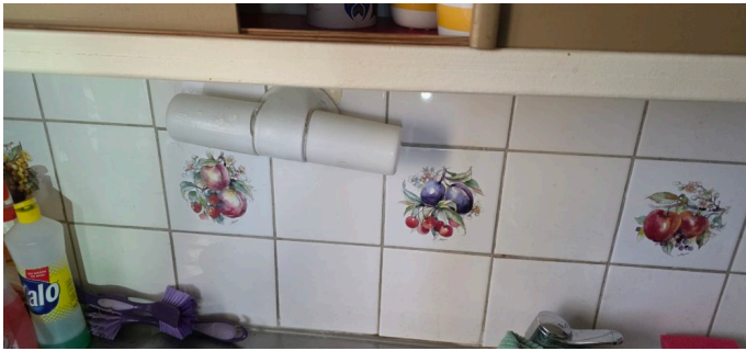
Bilde 1 Veggarmatur er løs. Ser ut som feste er defekt.
