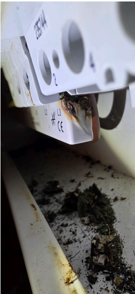
Bilde 1 Varmegang bør fikses snarest.
