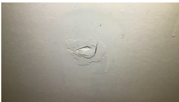
Eksempel på slitasje på dør.
