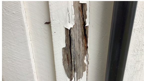
Eksempel på råteskadet bordkledning.
