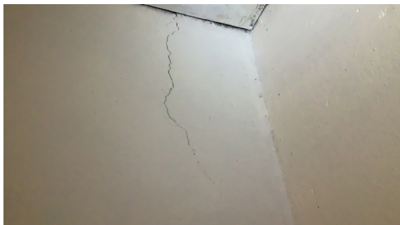
Riss i pipe.
