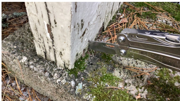
Råteskadet stolpe for tilbygget tak
