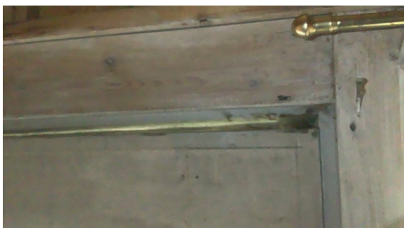
Det lyser inn mellom dør og dørkarm.
