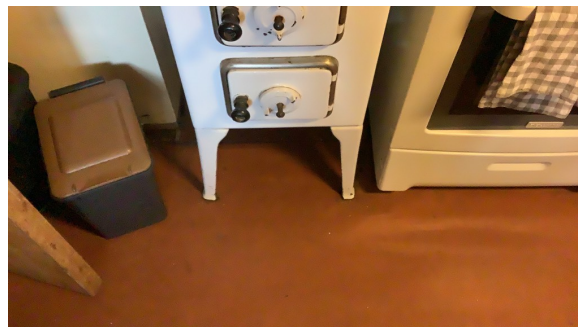
Manglende ildfast plate på gulv under ildsted.
