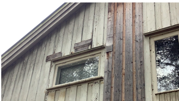
Ubehandlet bordkledning, og spredte råteskader over vindu.
