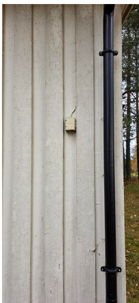
Bilde 1 Stikk er montert feil vei. Skal monteres vannrett for å beholde ip grad for vann.
