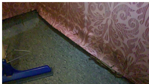
Våtromstapet har revnet og løsnet fra vegg i dusjhjørnet.
