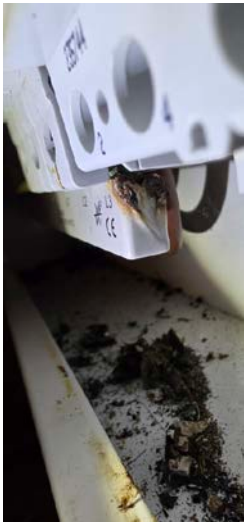
Bilde 1 Varmegang bør fikses snarest.
