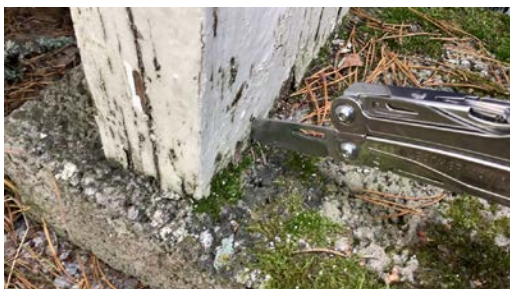
Råteskadet stolpe for tilbygget tak
