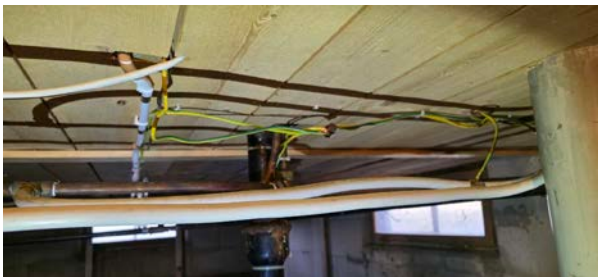
Bilde 3 Løs jordledning, mangler noen fester. Kjellertak under kjøkken.
