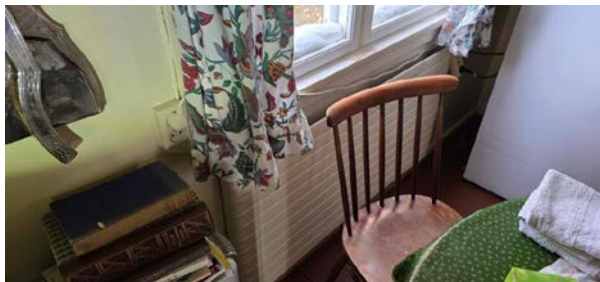
Bilde 1 Ujordet stikk ved ledende radiator til kjøleskap på kjøkkenet medfører berøringsfare.
