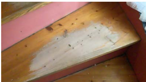
Slitasje i trapp.
