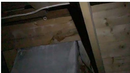
Fuktskjolder i taktro inntil pipe.
