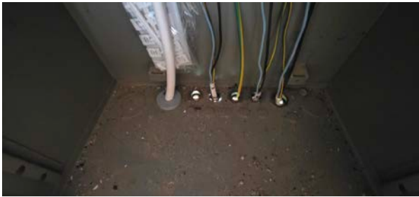
Bilde 3 En del manglende nippler, tetting i tavle 2 etasje.
