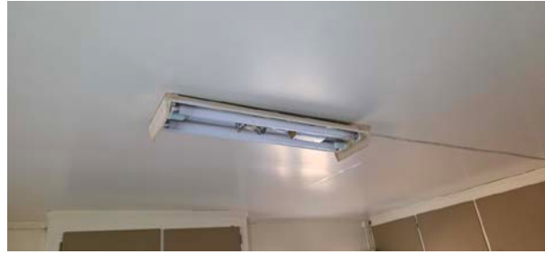
Bilde 2 Lampe tak mangler skjerm og er løs i enden
