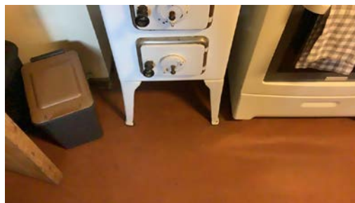
Manglende ildfast plate på gulv under ildsted.
