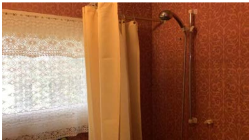
Vindu er plassert i den definerte våtsonen.
