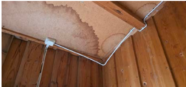
Bilde 2 Kabel er løs og bør festet. Entre.
