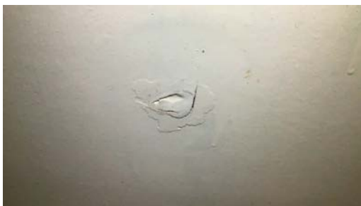
Eksempel på slitasje på dør.
