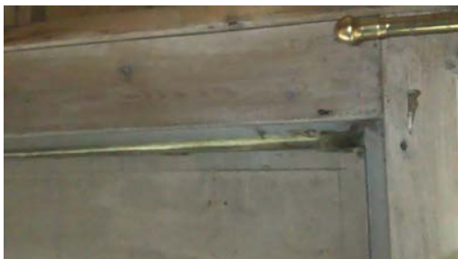
Det lyser inn mellom dør og dørkarm.
