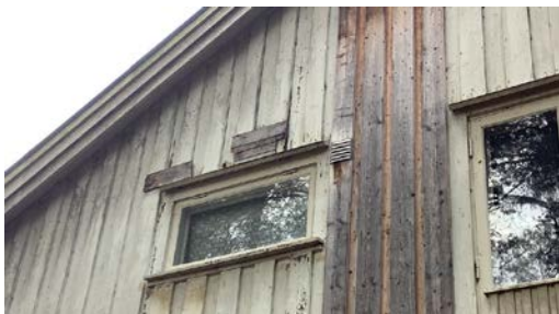
Ubehandlet bordkledning, og spredte råteskader over vindu.
