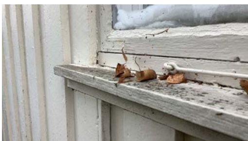
Vannbrett har ikke tilfredsstillende fall fra vindu.
