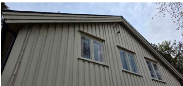
Bilde 5 Gamle inntakskabel bør fjernes.
