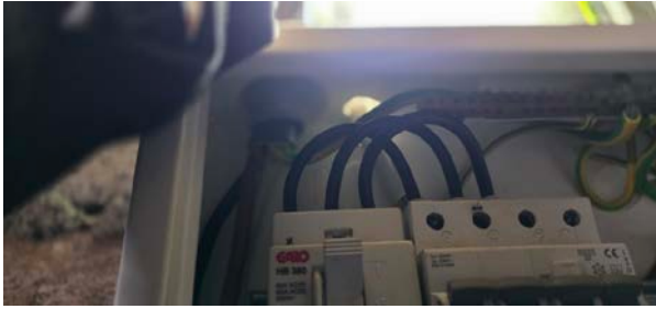
Bilde 1 Nippel mangler i skap kjeller.
