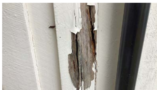
Eksempel på råteskadet bordkledning.
