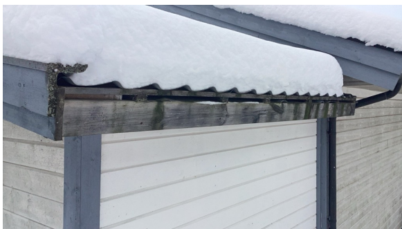
Det er ikke takrenne og beslag på takoverbygget veranda.
