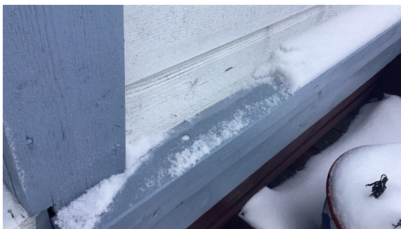
Trekledning på innebygget veranda går helt ned på gulvbord.
