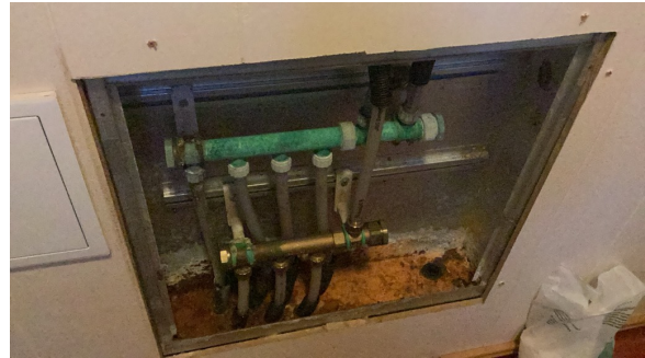
Lekkasje inne i fordelerskap.
