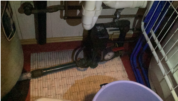
Vanninntak med stoppekran.
