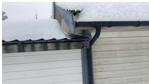
Takoverbygget veranda har ikke tett overgang mellom tak og vegg på bolighus.
