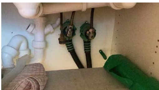
Kobling med veggbokser.
