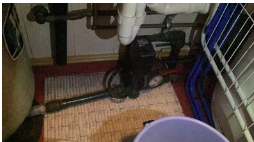
Vanninntak med stoppekran.
