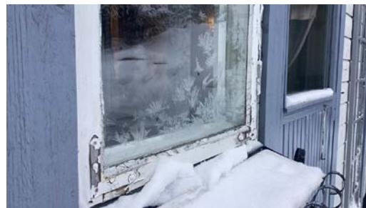
Eksempel på slitasje på vindu på innebygget veranda.
