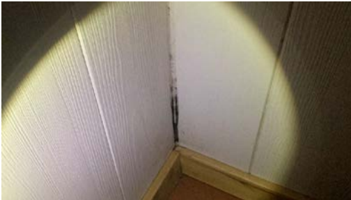
Svertesopp i vegg hjørne mot nord-øst.
