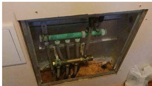
Lekkasje inne i fordelerskap.
