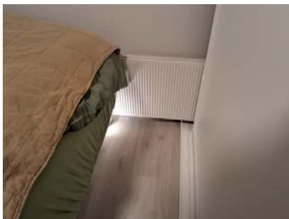
Leiligheten er oppvarmet med radiatorer tilknyttet fjernvarme.
