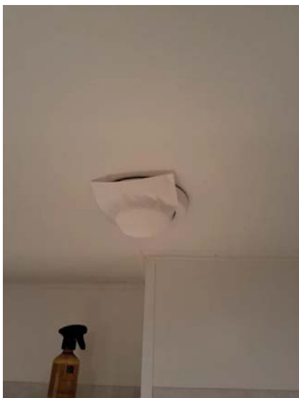
Avtrekkseffekt er testet med papir.
