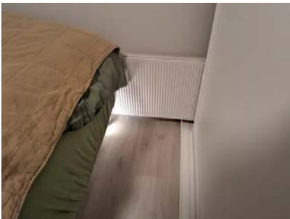
Leiligheten er oppvarmet med radiatorer tilknyttet fjernvarme.
