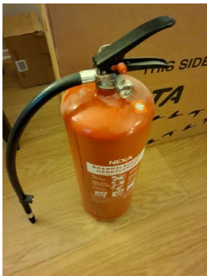
Brannslukningsapparat er kontrollert i 2022.
