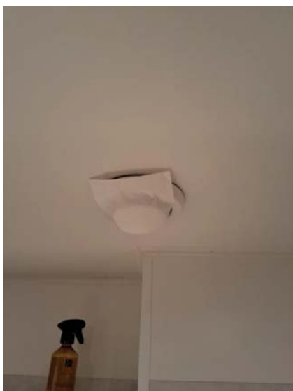
Avtrekkseffekt er testet med papir.
