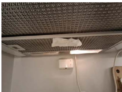
Avtrekkseffekt er testet med papir.
