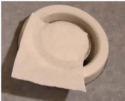
Avtrekkseffekten er testet med papir.
