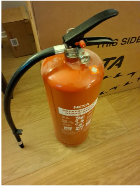
Brannslukningsapparat er kontrollert i 2022.
