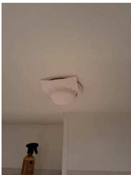
Avtrekkseffekt er testet med papir.
