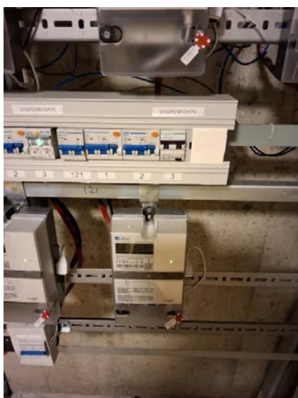
Sikringer tilhørende leiligheten er plassert i felles sikringskap.
