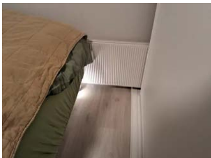
Leiligheten er oppvarmet med radiatorer tilknyttet fjernvarme.
