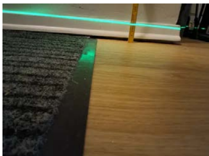
Det registreres glippe mellom gul og gulvlist som følge av ujevnt gulv.
