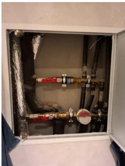
Åpen rørfordeling med stoppekraner er plassert i sjakt på bad.
