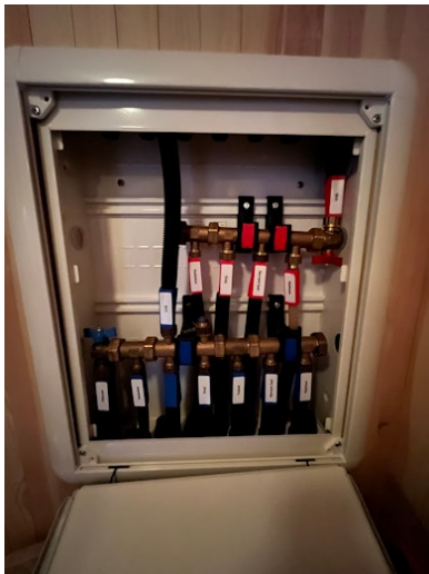
Fordeler skap plassert på vaskerom
