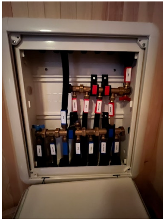
Fordeler skap plassert på vaskerom
