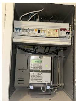
Sikringsskap med automatsikringer.
