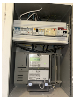
Sikringsskap med automatsikringer.
