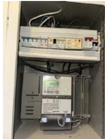
Sikringsskap med automatsikringer.
