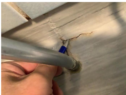
Rørgjennomføringer i dusjsone er utett.
