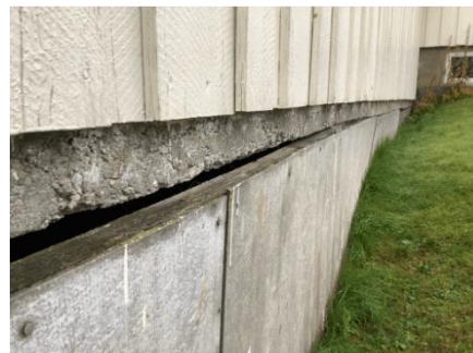
Endeved på utvendig kledning har ikke dryppkant, Eternittplater til kledning mot krypkjeller.
