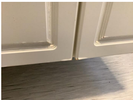
Svelling i dører på innredning.
