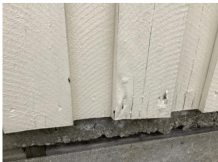
Råteskadet kledning enkelte plasser.
