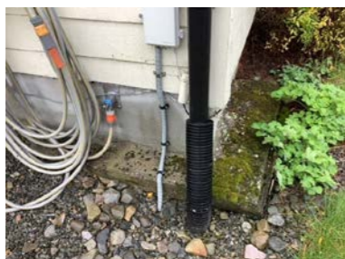
Bilde av betongforsterkning fra utside. Ukjent når dette er utført og om det har ønsket effekt på forsterkning av den eksisterende murveggen.
