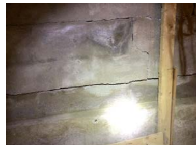
Muren har horisontale sprekker og forskyvning fra innside.
