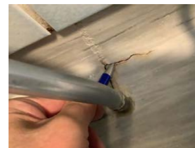
Rørgjennomføringer i dusjone er utett.
