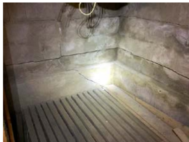
Muren har horisontale sprekker og forskyvning.
