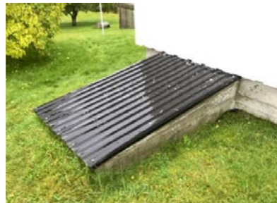
Utvendig inngang til kjeller. Det er stengt med plater over inngang. Tredør fra innsiden.
