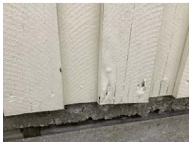
Råteskadet kledning enkelte plasser.
