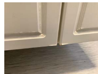
Svelling i dører på innredning.
