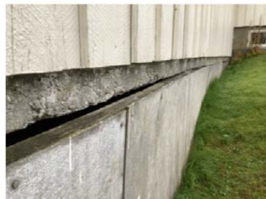
Endevep på utvendig kledning har ikke dryppkant, Eternittplater til kledning mot krypkjeller.
